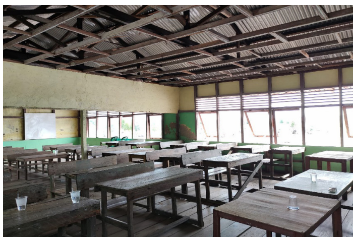
Gambar 4.1 Kondisi Ruang Kelas pada Salah Satu Sekolah di Desa Tanjung Pasir (Sumber: Dokumentasi Pribadi)
